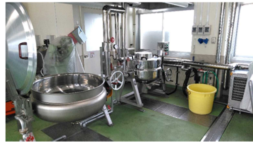
食品製造実習室内の加熱攪拌機 HACCP に対応した手順、充実した機械・設備
