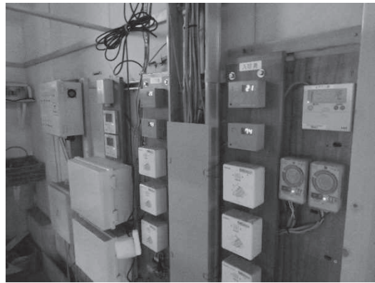
写真 2 シイタケ培養棟環境コントロール装置
